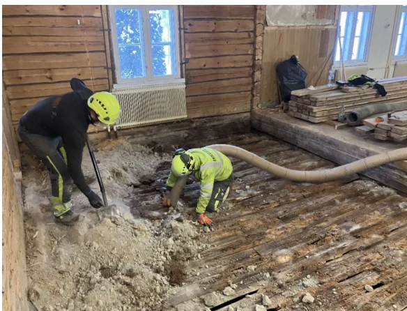
Pytingissä oli ylä- ja alapohjissa eristeenä ohut sammalkerros ja paksu savikerros. Paksu rossilaudoitusta nähtiin ehjältä, mutta ehjää puuta oli vain ohut kerros ja muu osa oli täysin lahonnut. Samasta syystä myös saveen kosketuksessa olleissa hirsiseiniin alaosissa oli paikallisia lahovaurioita.
